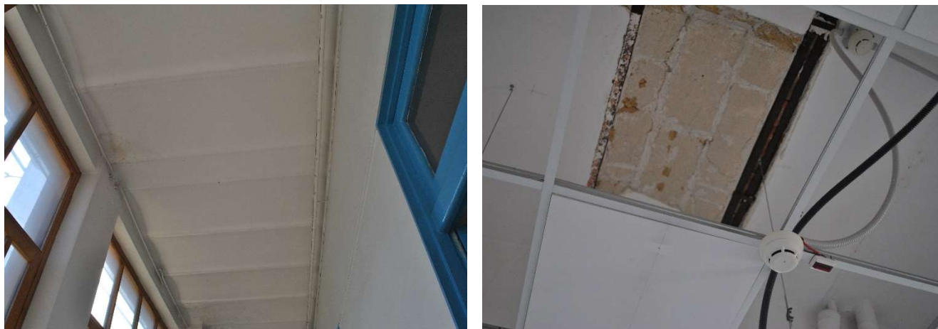
Fig.20. Solaio di interpiano con profili IPE 180 e voltine di muratura di calcarenite.
